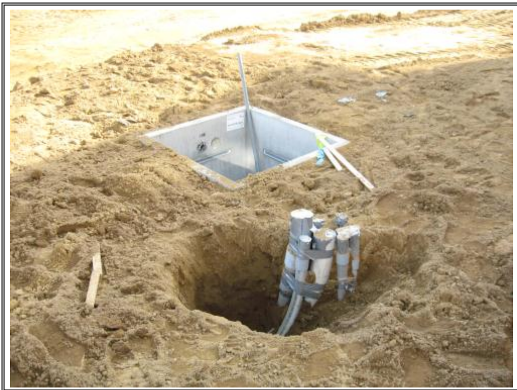
8. Electrical conduits and vault.
